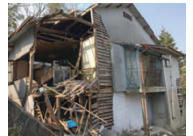
壁が崩れた空き家
